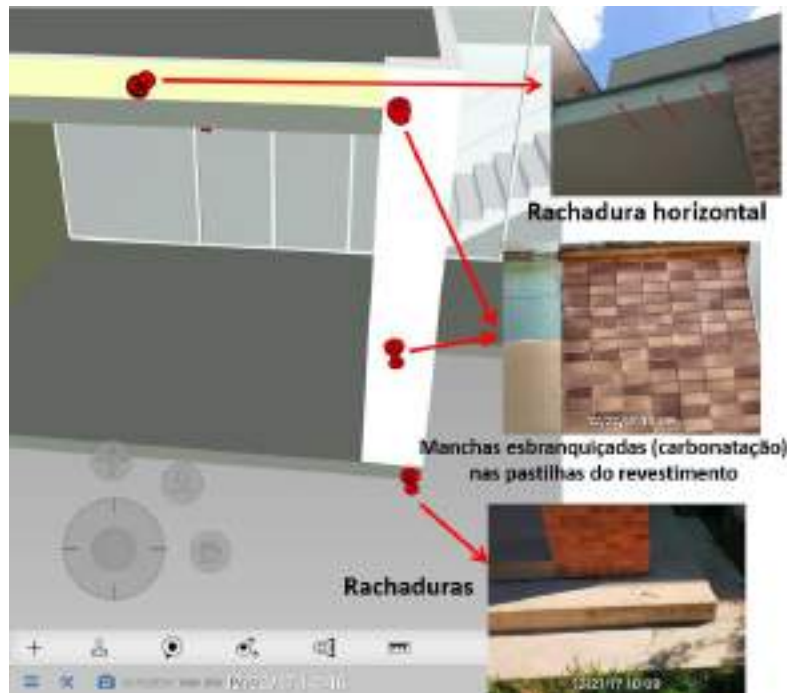
Figura 14. Exemplos de associação de pins com fotografias dos danos na fachada do CT-12.
