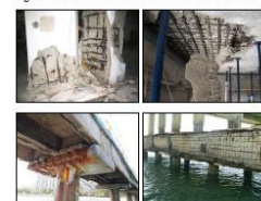
Figura 22. La realidad de las edificaciones por corrosión.
